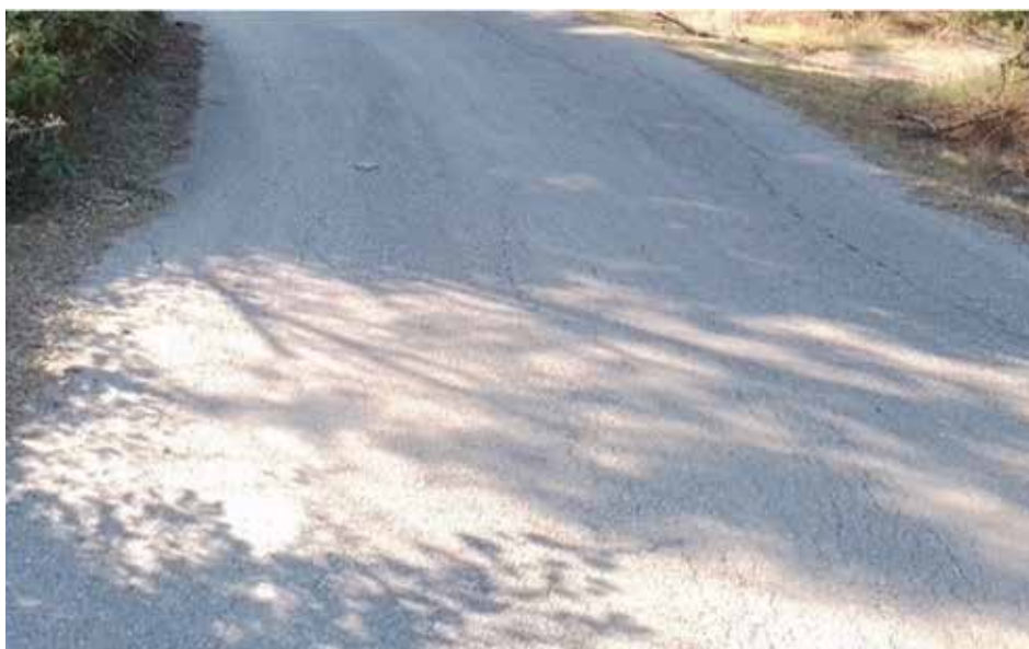
Εικόνα 7. Διάβρωση του οδοστρώματος Picture 7. Road surface erosion
