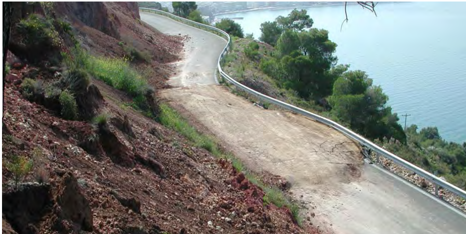
Εικόνα 1. Αστοχία πρανών της παρακαμπτήριας οδού της πόλης Λουτρακίου (Αντωνίου και Λέκκας Ε., 2005). Picture 1. Slope Failure of a detour road at Loutraki town (Antoniou & Lekkas, 2005).
