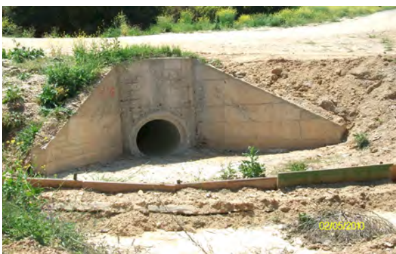
Εικόνα 10. Οχετός με επίχωση διπλάσια της διαμέτρου και πρόχειρο ξύλινο φράγμα συγκράτησης φερτών στην είσοδό του, δρόμος Α2Τ2 (Ψιλοβίκος, 2010).
