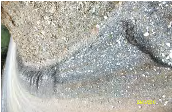
Εικόνα 9. Χαρακτηριστική διάβρωση τραπεζοειδούς διατομής τάφρου συλλογής ομβρίων σε ημι-κυκλική στον δασικό δρόμο Α2Τ2 (Ψιλοβίκος, 2010).
