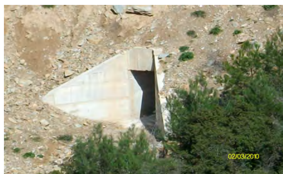
Εικόνα 7. Κιβωτοειδής οχετός με περυγότοιχους στο δασικό δρόμο Γέφυρα Περεβού – Μονή Κοιμήσεως Θεοτόκου (Ψιλοβίκος, 2010).
