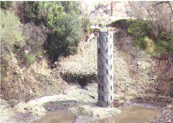
Εικόνα 14. Εφαρμογή μεταλλικού διάτρητου σωλήνα στον πόδα πρανούς για τη συλλογή και μεταφορά υδάτων (Napper, 2006).
