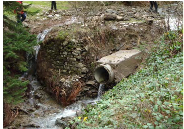
Εικόνα 3. καταστροφή τοίχου αντεπιστροφής σωληνωτού οχετού δασικού δρόμου «Μπράικο» στο Πανεπιστημιακό δάσος Περούλιου (Διοίκηση Παν/κού Δάσους Περούλιου, 2010).
