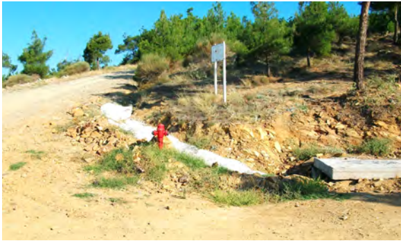
Εικόνα 8. Συνδυασμός ρεϊθρου-τάφρου συλλογής ομβρίων και σκεπαστού φρεατίου εισόδου οχετού σε διασταύρωση δρόμου-αντιπυρικής λωρίδας, στο δρόμο Α1Τ1 (Ψιλοβίκος, 2010).
