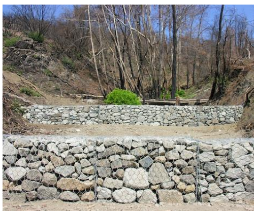
Περιοχές κοιτών που διαπλατύνθηκαν λόγω διάβρωσης
