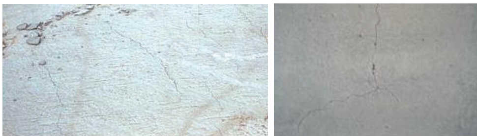
Σχήμα 1 - Ρηγμάτωση σκυροδέματος σε πλαστική κατάσταση
