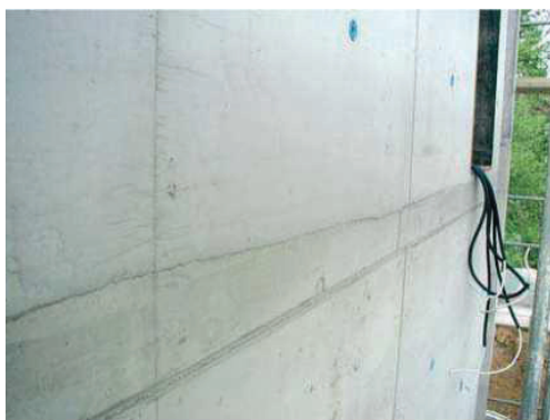
Εικόνα 7 - Εμφανής αρμός εργασίας (μη αποδεκτός)
