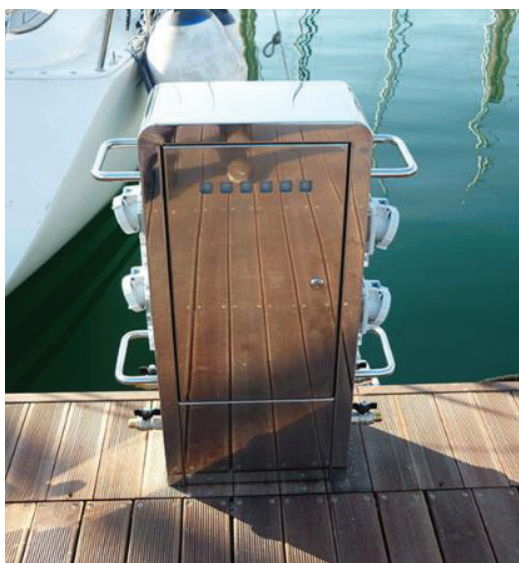
Εικόνα 4: Κιβώτιο παροχής νερού και ενέργειας
