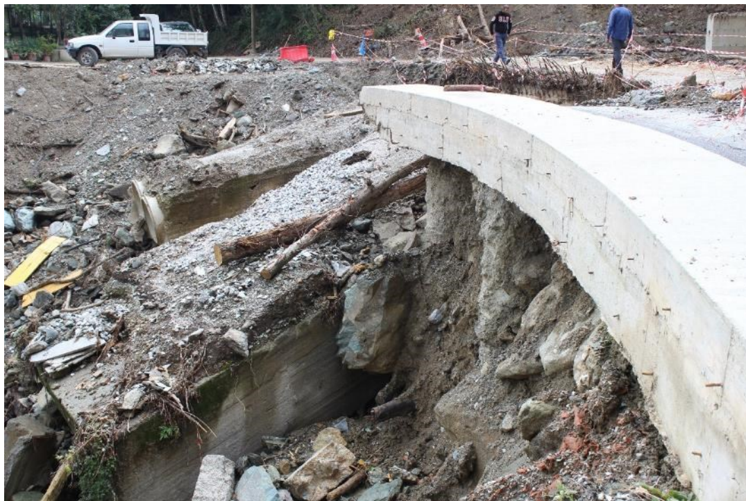
Καταστροφές στην γέφυρα, παρά το σημαντικό τεχνικό έργο που υπήρχε.
