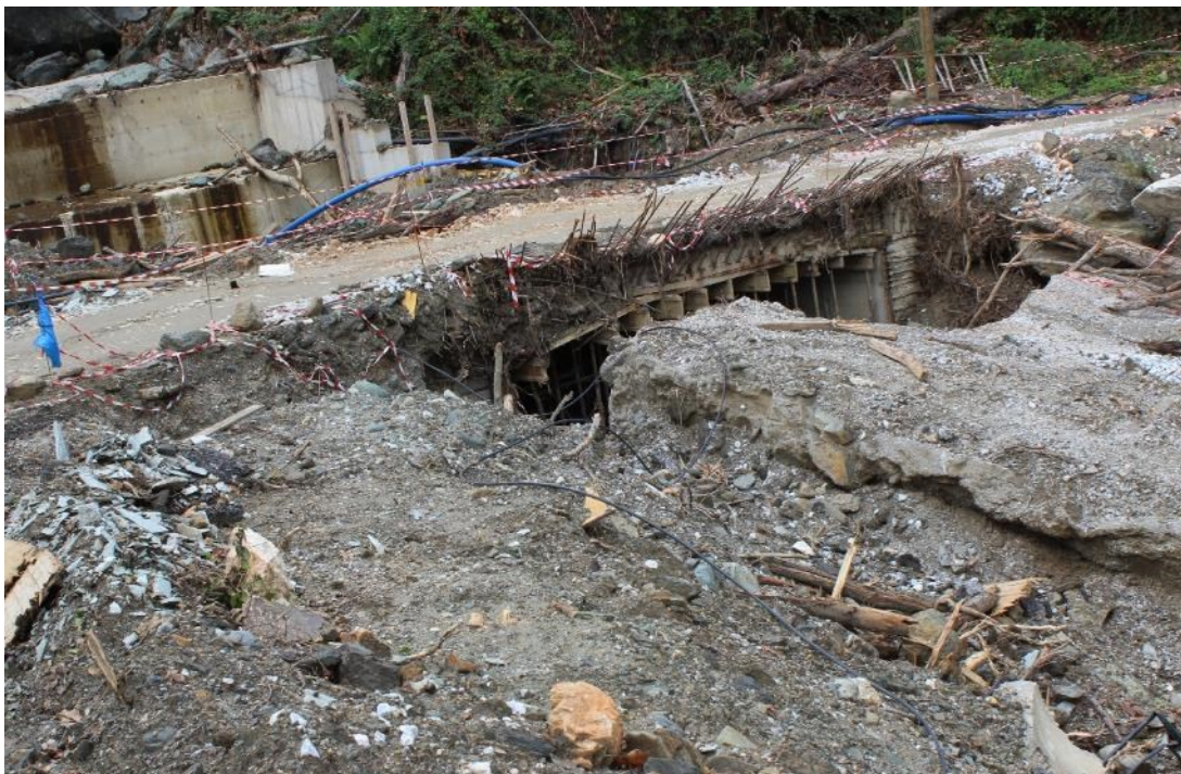
Καταστροφές στο σημείο την γέφυρας του δρόμου από Ζαγορά προς Πουρί.
